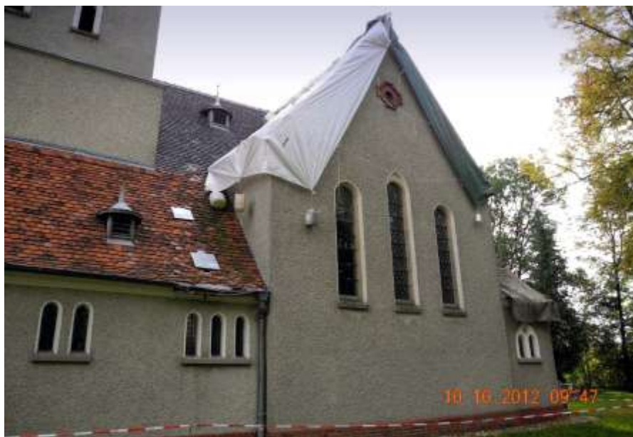
Sturmschäden an der Kirche ib Grambschütz
